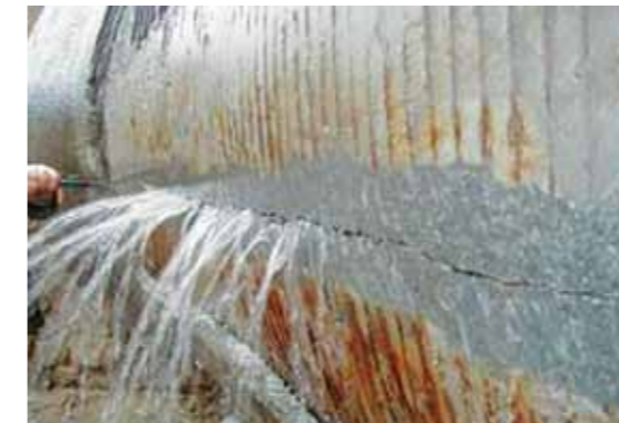
Şekil 3. ÖGGB Borularda Dökülen Dış Harç ve Korozyona Maruz Kalan Öngerme Donatıları (Fyfe Europe'ın izni ile)
